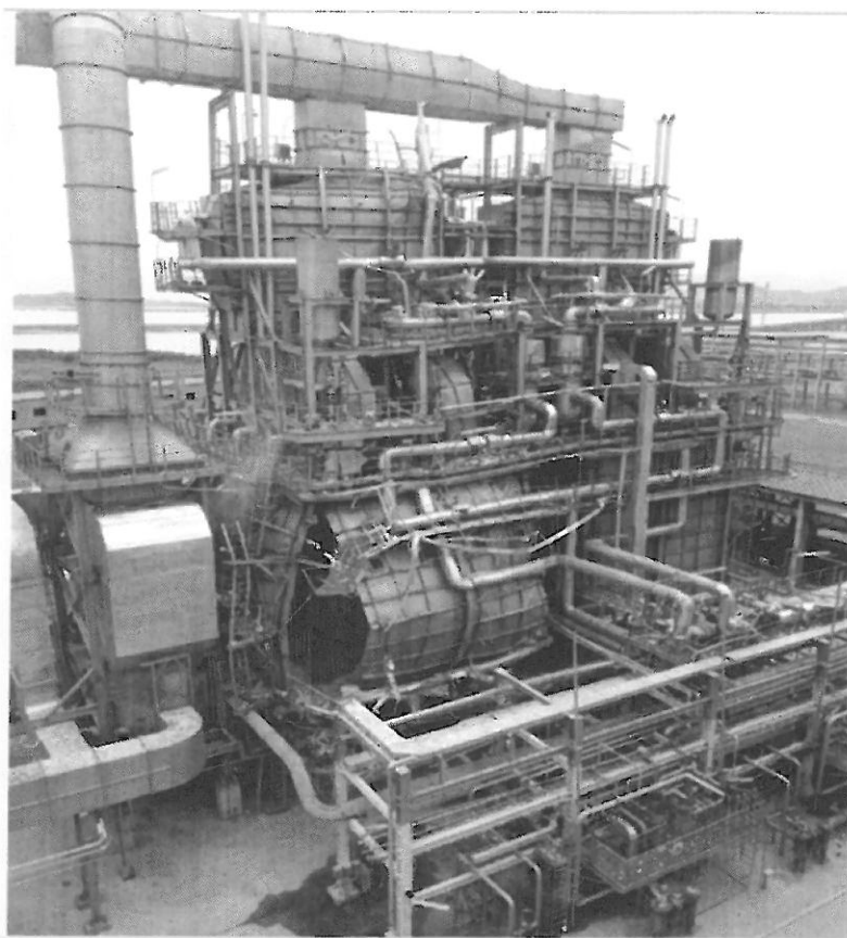
图五：蒸汽过热炉单元“2·18”闪爆事故现场
