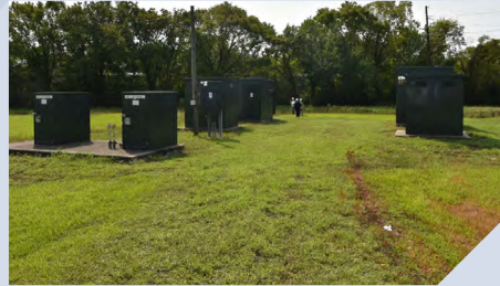
Transformadores en la instalación.
